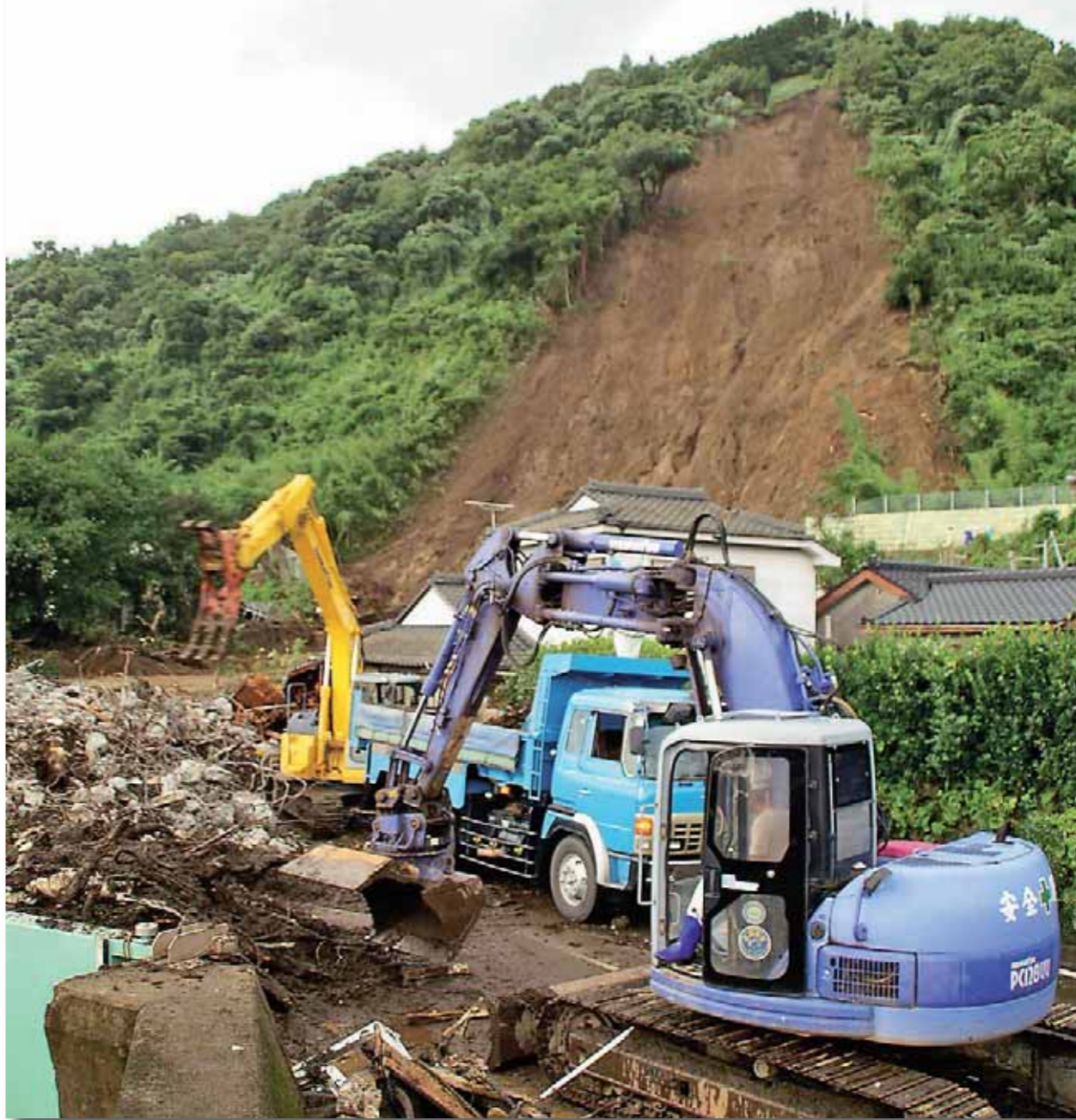
垂水市二川の郵便局など計5戸が全壊した土砂崩れ現場
